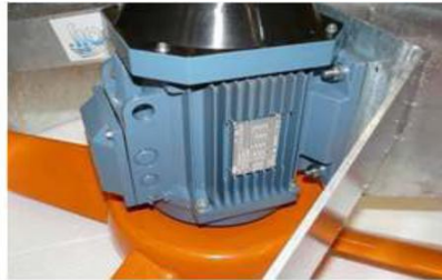
Защитная сетка на вентиляторы
